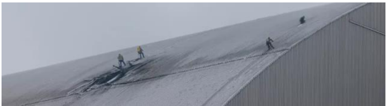
ФОТО ДСНС. Наслідки удару безпілотної по захисній конструкції на Чорнобильській АЕС
